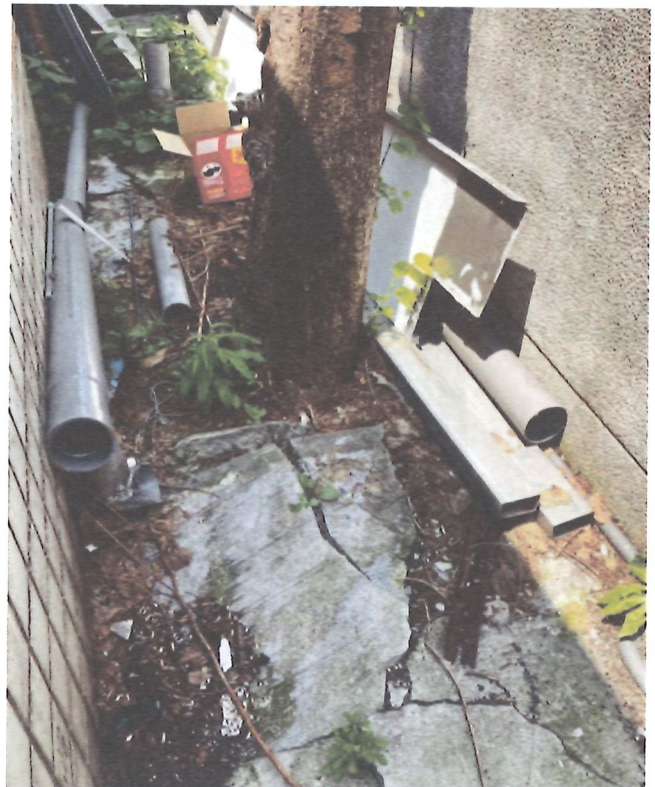
基部雜物堆積，根系造成周圍鋪面破損突起
